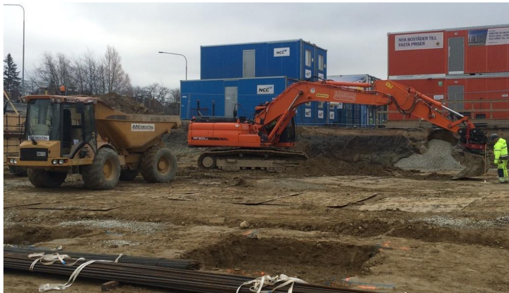
Figur 14. Foto på grävmaskin och dumper vid arbete med terrassjustering. Anläggningsarbetare kontrollerar nivå med rotationslaser. I förgrunden en färdigschaktad plintgrop.
