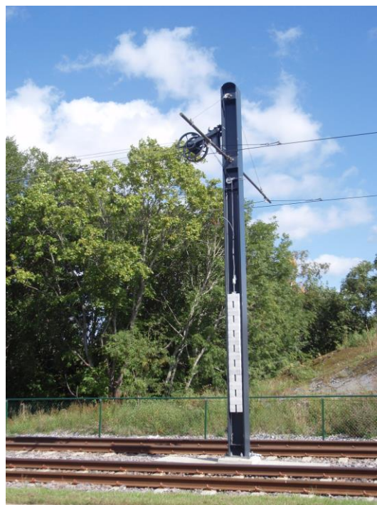
Figur 14. Viktavspänning med viktpaket monterat i H-balk.
