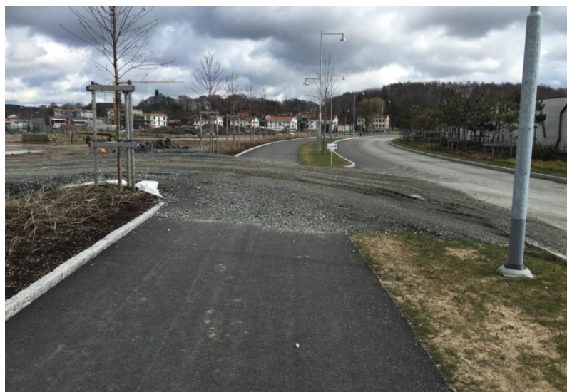
Figur 56 - Grus över ny gång - och cykelbana för att kunna köra in till byggarbetsplats, utan varningsmärken.
