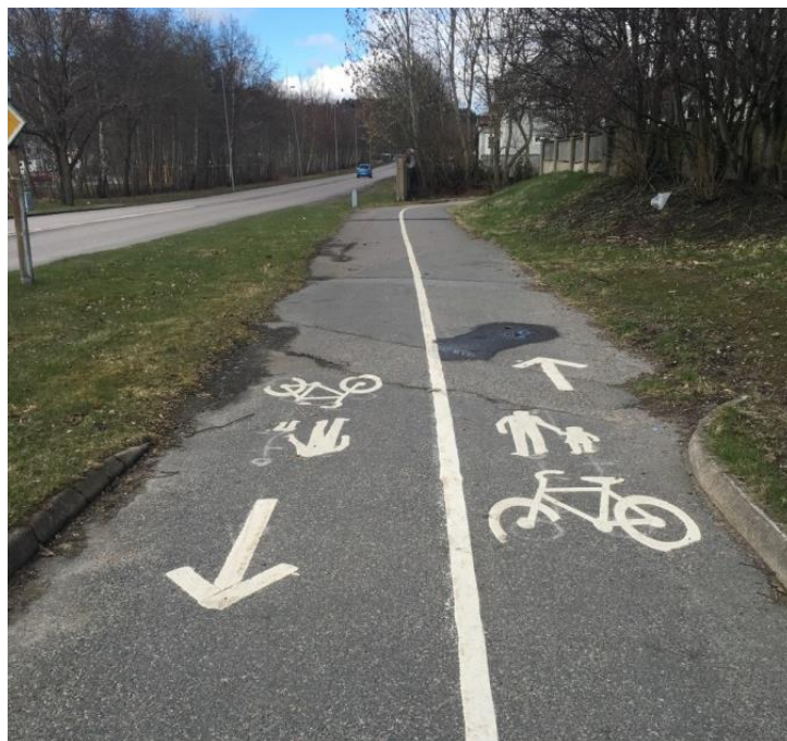
Figur 48 – Bristfällig kombinerad gång- och cykelbana.
