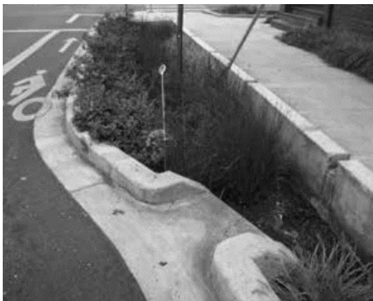
Figur 16. Regnbädd med släpp i kantstenen (Uppsala vatten, 2014).
