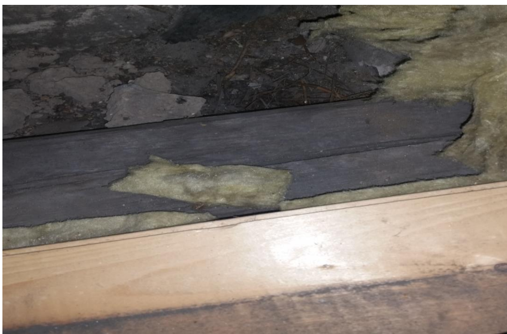
Figur 3-11: Remstycke och spåntat golv intill murupbyggnaden.
