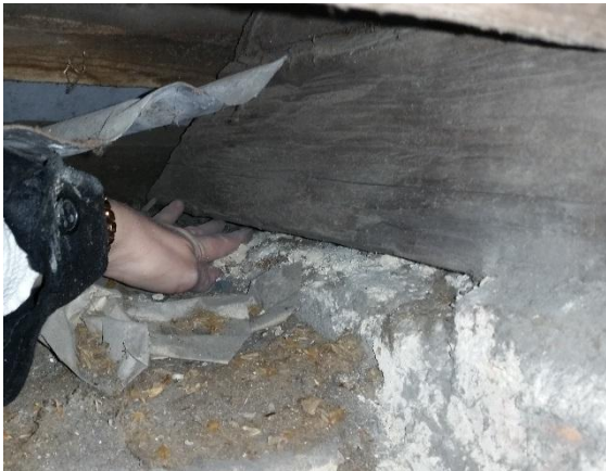
Figur 5-2: Dragsträva på murupbyggnad.
