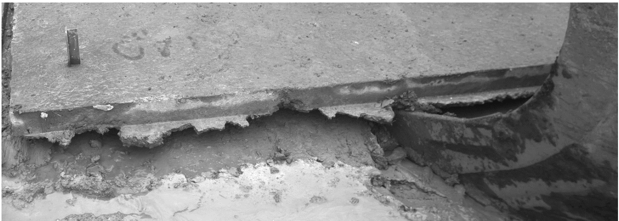
Bild 13. I bild framgår att betongen har flutit ut på sidorna av plattan.
