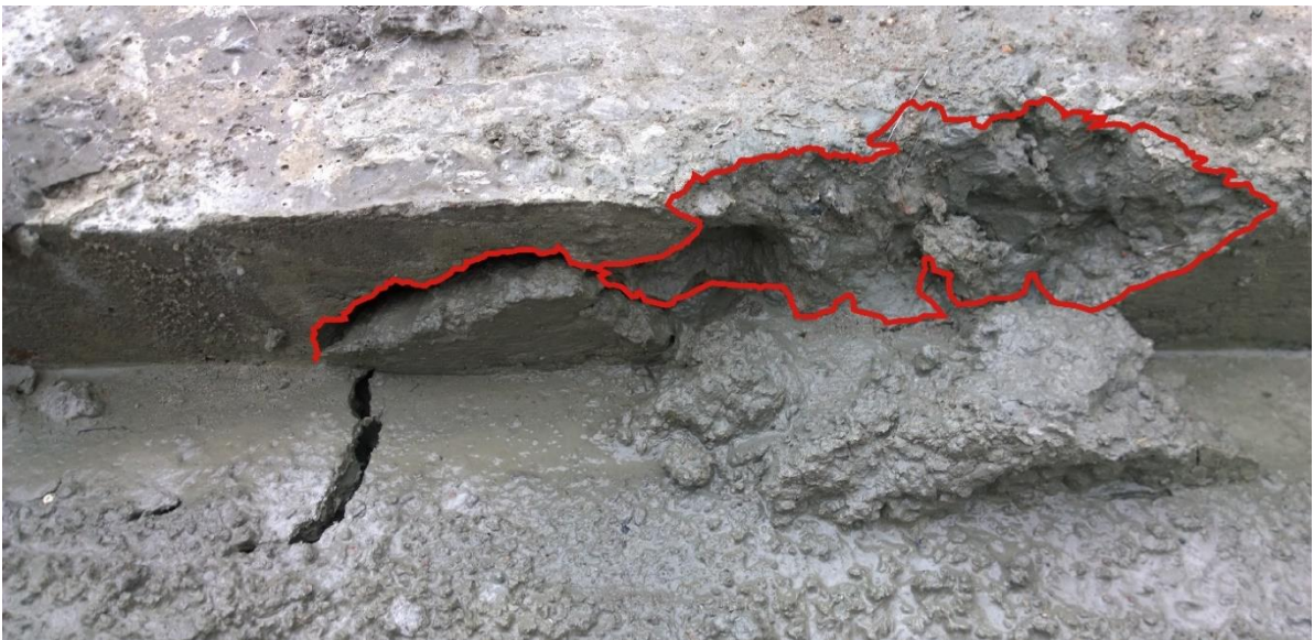
Bild 12. Leran går upp i betongplattan, brottet har gått i leran samt hur leran och betongen har blandat sig och sen kollapsat till höger i bild.
