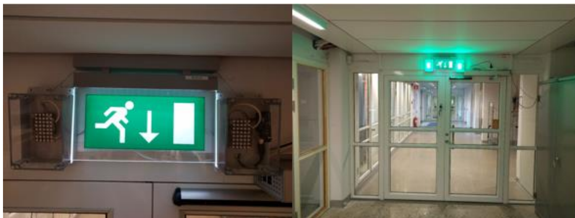
Figur 11. Utformning och installation av det dynamiska vägledande systemet. Observera att detta inte är den installation som användes vid försöken.
