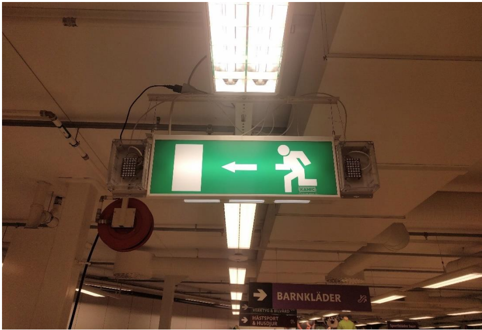
Figur 12. Installation av dynamiskt system vid försök inne i varuhuset.
