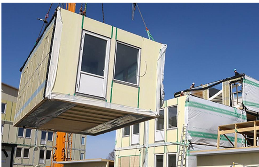
Figur 4. Montering av volymelement i Vinsta, Stockholm. Källa: Svenskt Trä. Foto: Johan Ardefors.
