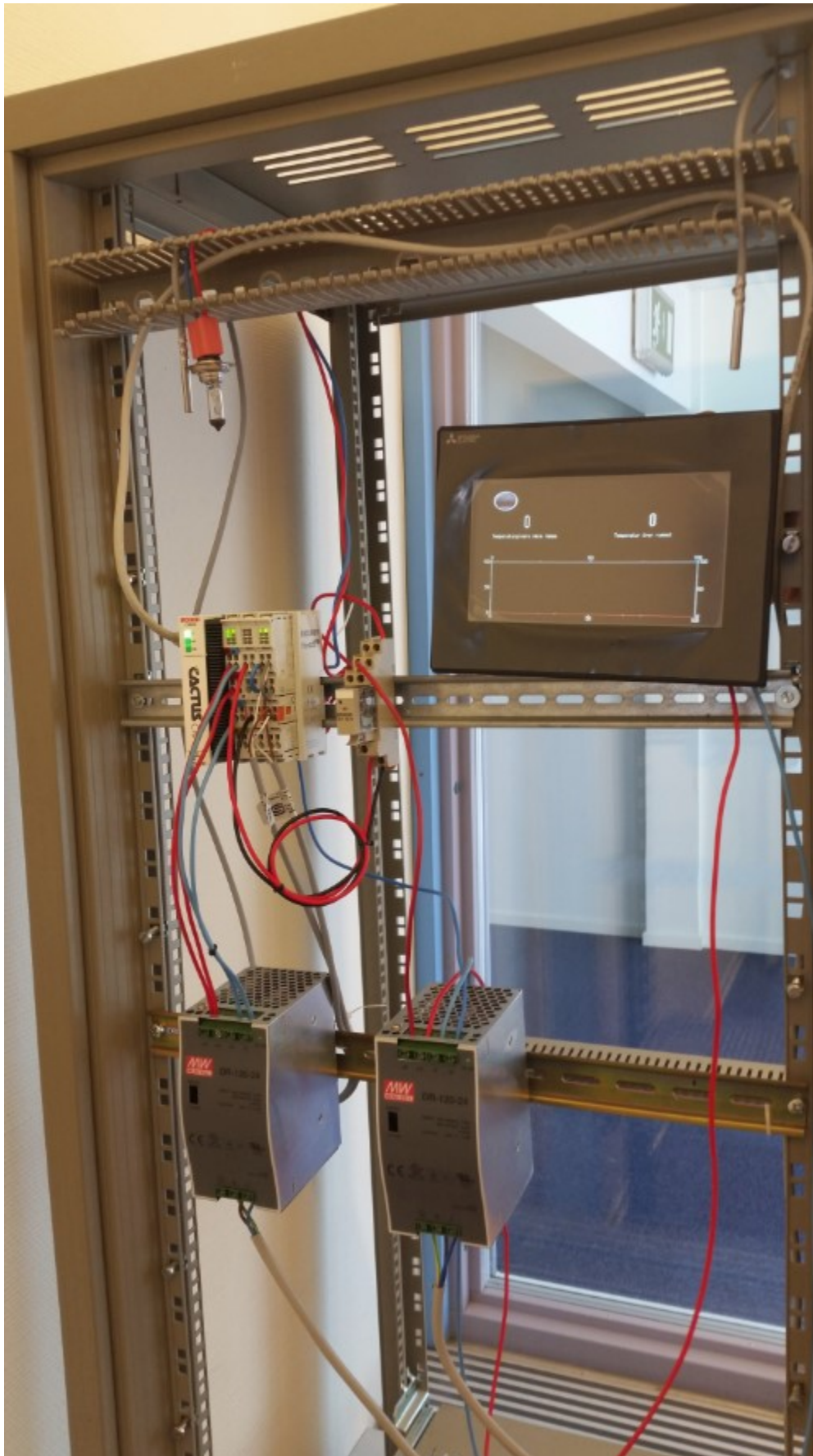
Bilaga 8 - Testmiljö med PLC, lampa, temperaturgivare, HMI-panel och likriktare.
