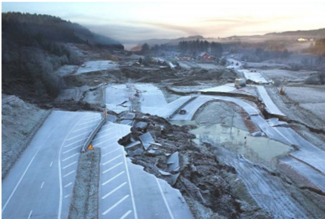
Fig. 2.11. Delar av E6:an och Bohusbanan förstördes i ett stort lerskred år 2006. Bild från Rosvall & Kjellberg (2009).
