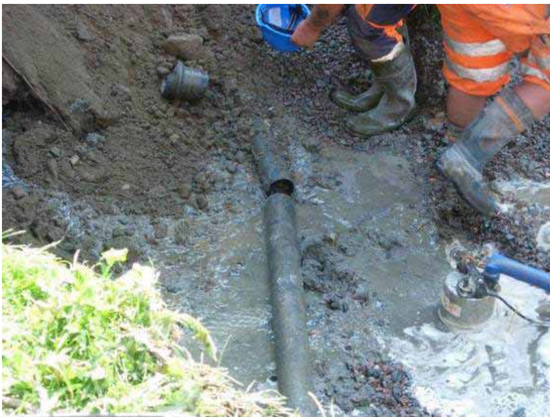
Figur 4.8 Västra Gryet – tryckledning
