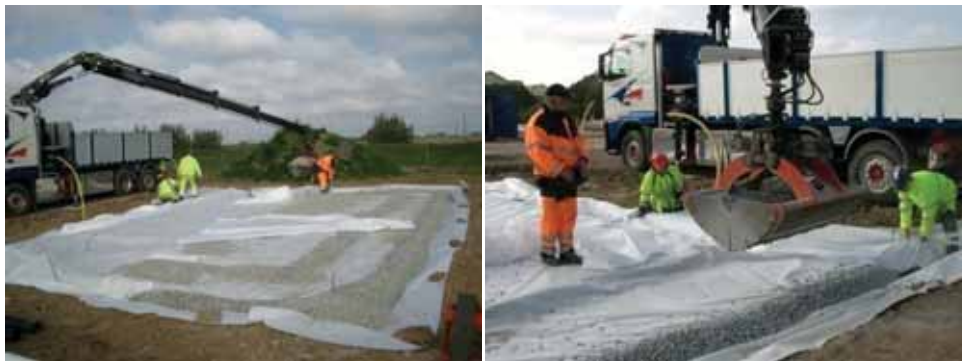
Figur 3.8 och 3.9 Utläggning av dränerande och kapillärbrytande material
