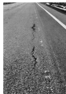
Figur 7.3 Sprickbildning med skadegrad 3.
