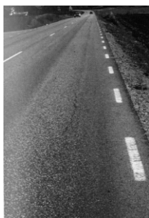
Figur 7.1 Sprickbildning med skadegrad 1.
