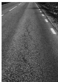
Figur 7.2 Sprickbildning med skadegrad 2.
