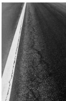
Figur 7.4 Krackelering med skadegrad 1.
