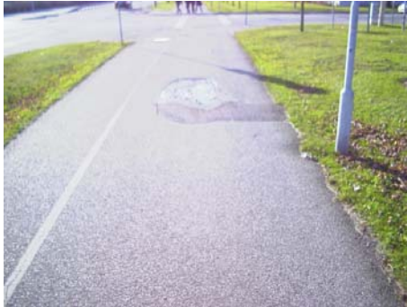
Sektion 9920: En mindre väl utförd lappning vilket härleds vara anledningen till att Rambölls beräkningsmodell klassificerar sektionen som dålig.
