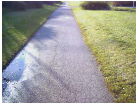
Figur 7.9 Sektion som klassificerats som komfortmässigt dålig av Rambölls beräkningsmodell vilket kan härledas till den krackelerade beläggningen.
