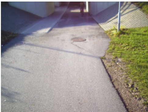
Sektion 7480: Sättningar kring brunnen i bild och skarven i beläggningen gör att båda modellerna påvisar en dålig komfort i denna sektion.
