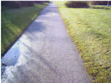
Sektion 11560: I det inledande partiet av delsträckan skiljer sig beräkningsmodellernas klassificering åt markant. Mellan sektion 11530 och 11600 är beläggningen av relativt låg standard och i regel krackelerad likt på bilden.
