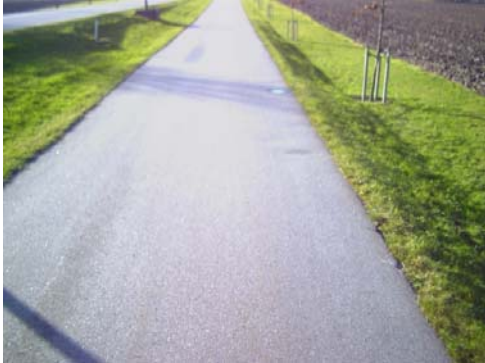
Sektion 6770: En gropighet i kanten av cykelvägen härleds vara orsaken till att en dålig komfort påvisats av VTI.
