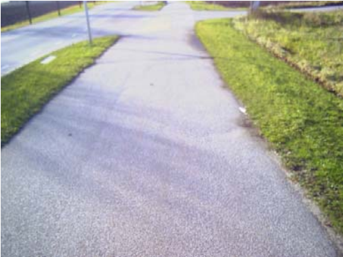
Sektion 6600: En beläggningskant samt mindre sättningsrelaterade ojämnheter återfinns strax innan en överfart vilket har föranlett en dålig komfortklassificering av de båda beräkningsmodellerna.
