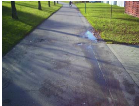
Sektion 7880: Potthål och en allmänt skadad beläggning är signifikativt för sträckan mellan sektion 7880 och 7930. Sträckan klassificeras som sämre av Ramböll än av VTI.
