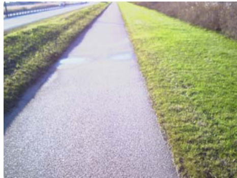
Sektion 11920: På sträckan mellan sektion 11690 och 12270 återfinns många mindre kantskador, gräsintrång och sättningsrelaterade problem omkring bland annat brunnar. VTI:s beräkningsmodell har klassificerat större delen av denna sträcka som dålig.
