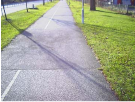
Sektion 9570: En mindre skarv samt en sättning vid lagningen av cykelvägen föranleder att Ramböll klassificerar sträckan som dålig och VTI den som medelbra.
