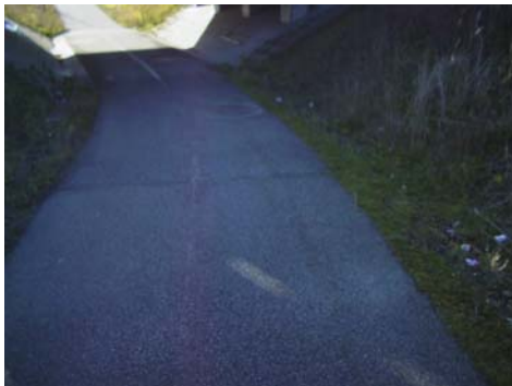
Sektion 90: Vid sektion 90 indikerar VTI för en mindre väl utförd lappning emedan Ramböll vid sektion 100 och 110 istället reagerar på mer utbredda ojämnheter i tunneln.
