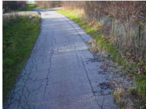
Sektion 11170: Från sektion 10900 och framåt är delsträckans beläggning krackelerad och allmänt eftersatt. Bilden över sektion 11170 är representativ för sträckan som av båda modellerna klassificerats som övervägande dålig.
