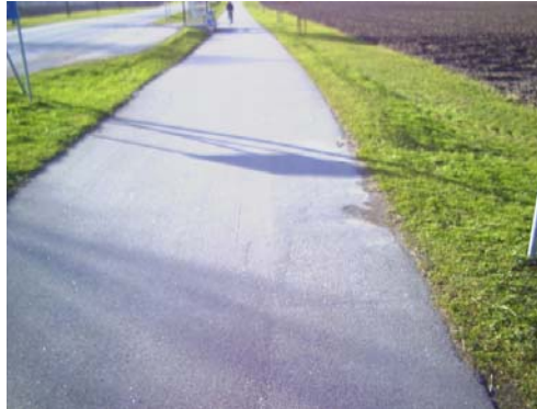
Sektion 6640: Ojämnheter i kanten av cykelvägen har föranlett att en medelbra komfort beräknats av VTI emedan en dålig komfort beräknats av Ramböll.
