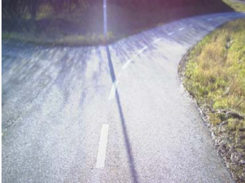
Sektion 1370: De tre 10-meters sektioner som av Rambölls beräkningsmodell klassats inneha en mindre bra komfort härleds bero av de utbredda ojämheterna längs med sträckan orsakade av sättningar.
