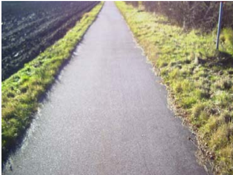
Figur 7.10 Sektion som enligt Rambölls beräkningsmodell påvisat en dålig komfort på grund av knappt synbara sättningsrelaterade ojämnheter.
