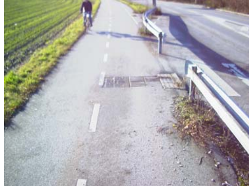
Sektion 2900: Rambölls komfortvärde indikerar vid denna sektion på dålig komfort vilket ur bild syns bero av de sinusplattor som leds ut i cykelvägen.
