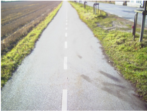
Sektion 3040: Sträckan mellan sektion 3000 och 3300 har i ett antal 10-meterssektioner klassificerats som dålig komfort enligt Rambölls beräkningsmodell vars anledning är svårt att tyda.
