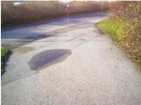
Sektion 10690: Ett antal lappningar efter schaktning antas vara anledningen till att båda beräkningsmodellerna klassificerar sektionen som komfortmässigt dålig.
