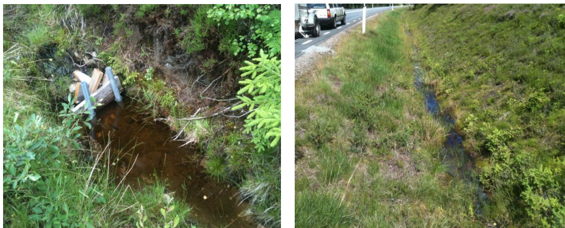
Figur 32 - Till vänster syns igensättning av dräneringsutloppet (Hansson et al., 2012). Den högra bilden visar vattenansamling i diket den 1 augusti (Erlingsson & Salour, 2011).
