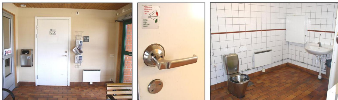
Figur 31. Bilden till vänster visar dörrens dåliga kontrast mot väggen i väntrummet. Mittenbilden visar toalettdörrens handtag och låsvred. Högra bilden visar hur toaletten ser ut invändigt.
