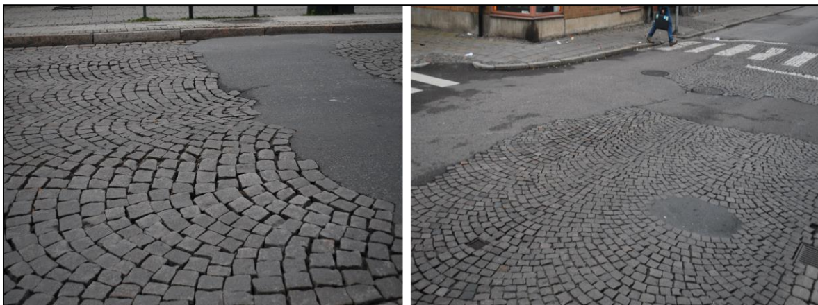
Figur 4.10. Ojämnheter på bristfällig gatustensbeläggning på Stora Södergatan. Lappad och lagad på sina ställen med asfalt.
