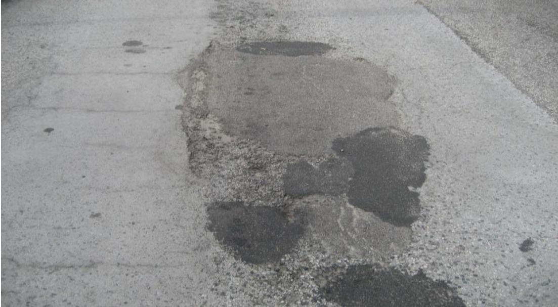
Figur 11 Skador vid lagning(Gatukontoret, 2014)
