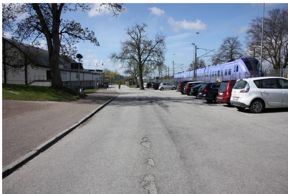
Bild 3 Högevallsgatan med beläggningsskador och parkerade bilar
