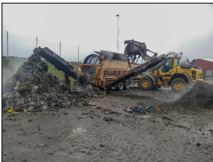
Figur 11. Pågående siktning där en hjullastare placerar avfall i en trumsikt. Längst fram på bilden kan den brännbara fraktionen ses till vänster och jordfraktionen till höger. På bilden sker en andra siktning av den brännbara fraktionen (avfallet som placeras av hjullastaren) vilket innebär att förhållandena mellan brännbar fraktion och jordfraktion inte motsvarar det av vanligt avfall (Bild: Samuel Svensson)
