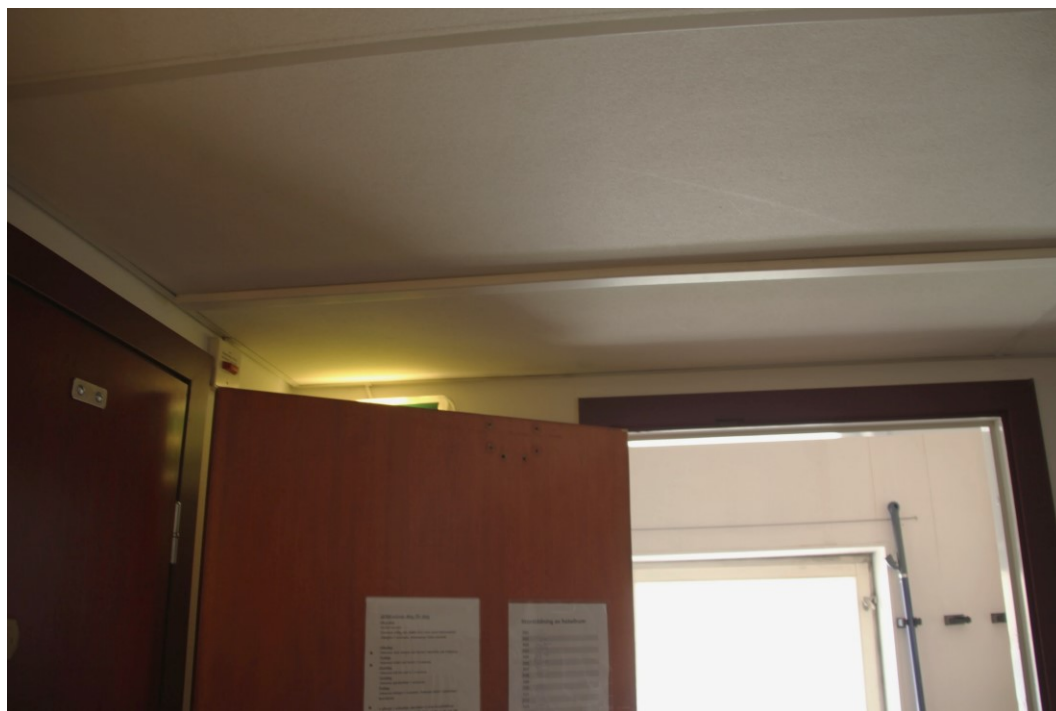
Figur 28. Exempel på skymd utrymningsskylt
