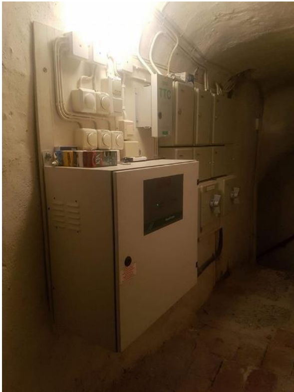
Figur 6 Bild på elcentralen.
