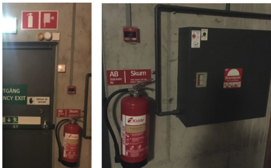
Figur 8. Skyltning av släckutrustning.
