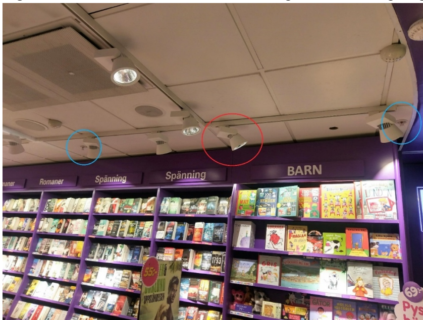
Figur 9. Pocketshop med spotlights samt sprinkler
