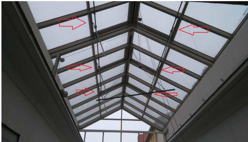
Figur 24. Brandgasventilation ovanför den östliga entrén, brandgasluckor är markerade med röda pilar.
