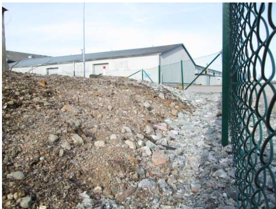
FOTOGRAFI 4 NIVÅSKILLNAD EFTER UTFYLLNAD I DIKE PÅ ARBOGA BYGG & MASKINTEKNIK, I SYDÖSTRA HÖRNET AV FASTIGHETEN (20180407).
