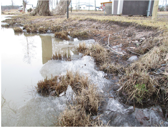
FOTOGRAFI 7 STRANDEROSION PÅ VÄSTRA DELEN AV TEGELUDDEN DEPONI (20180407).
