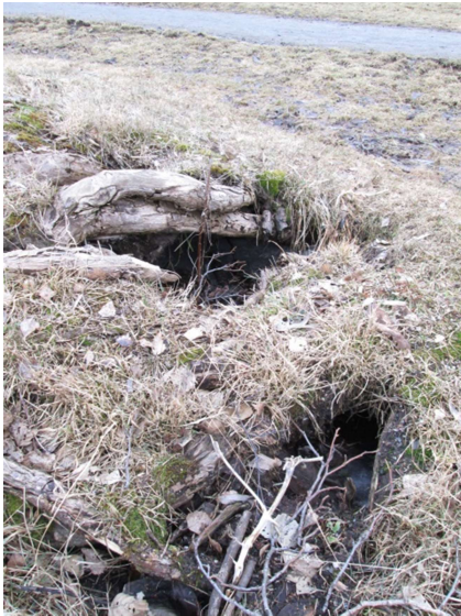
FOTOGRAFI 19 EROSIONSSKADOR VID STRANDKANTEN PÅ VÄSTRA DELEN AV TEGELUDDEN DEPONI (180407).
