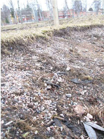
FOTOGRAFI 18 STRANDEROSION PÅ VÄSTRA DELEN AV TEGELUDDEN DEPONI (180407).
