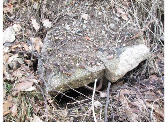
FOTOGRAFI 32 SKADOR PÅ TÄCKSKIKTET MED STÖRRE HÄLIGHETER I FYLLNADSMASSORNA PÅ EKUDDEN DEPONI (20180407)
