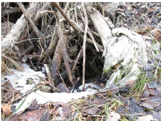
FOTOGRAFI 31 SKADOR PÅ TÄCKSKIKTET MED STÖRRE HÄLIGHETER I FYLLNADSMASSORNA PÅ EKUDDEN DEPONI (20180407).
