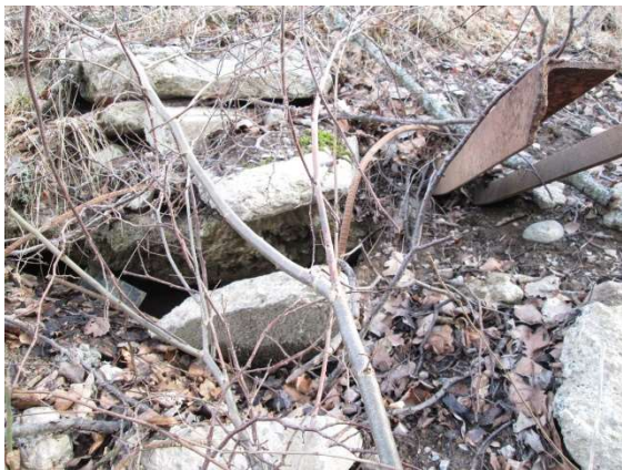
FOTOGRAFI 30 SKADOR PÅ TÄCKSKIKTET MED STÖRRE HÄLIGHETER I FYLLNADSMASSORNA PÅ EKUDDEN DEPONI (180407).
