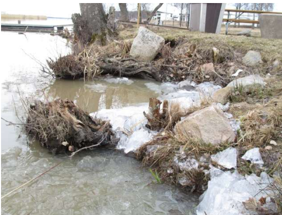
FOTOGRAFI 20 STRANDEROSION PÅ VÄSTRA DELEN AV TEGELUDDEN DEPONI (180407).
