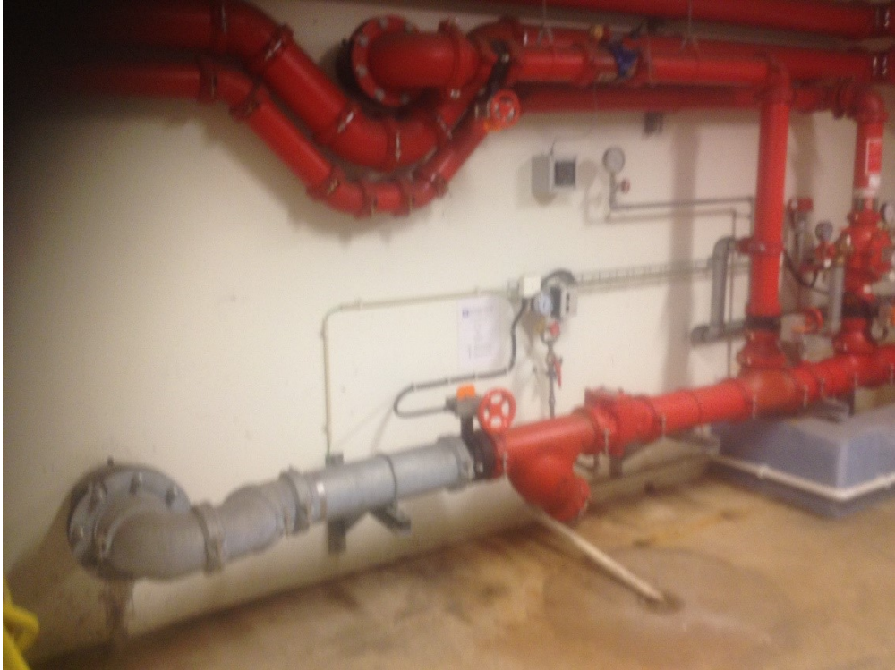
Figur 8: Inlopp till sprinklercentral i sprinkleranläggning E
