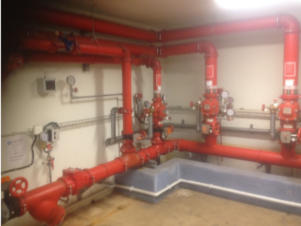
Figur 9: Bild över larmventiler mm. i sprinkleranläggning E
