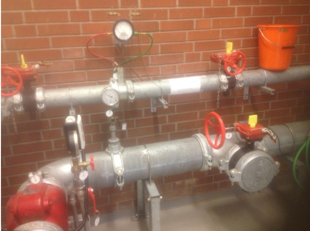
Figur 4: Sprinklercentral med manometer och ventiler
