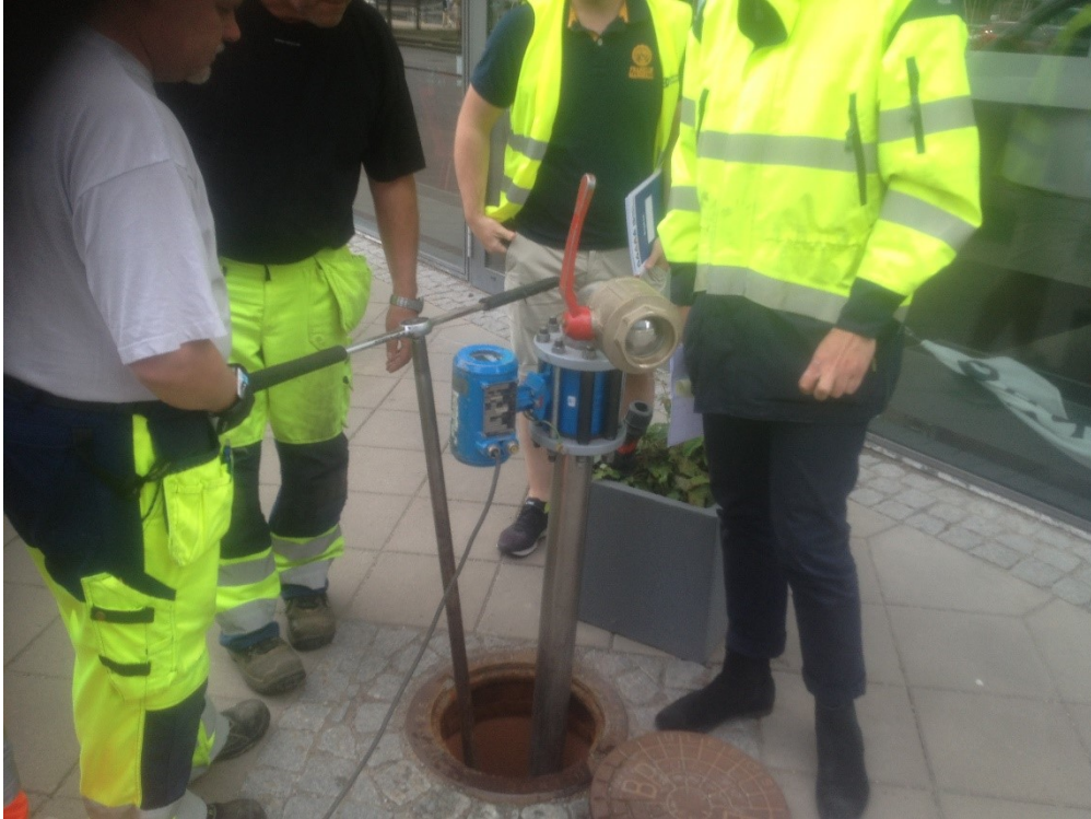
Figur 7: Brandpost i gatan där flöde tas ut (Brandpost Norr)
