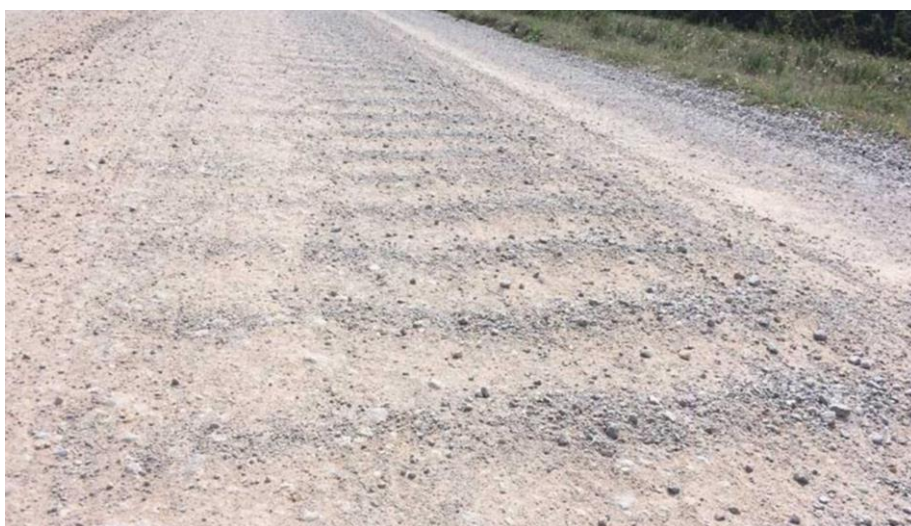
Figur 7. Korrugering (tvättbräda) (Foto: Mats Hannerz)
