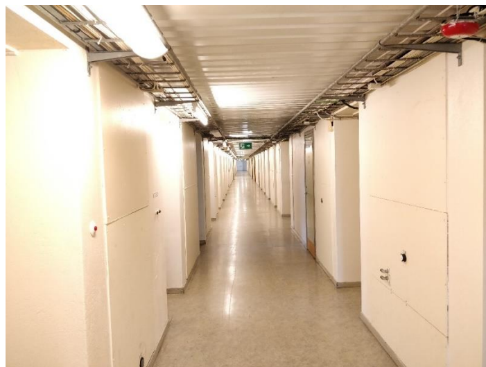
Figur 6. Överskådlig bild på höger korridor och allmänbelysningen.
