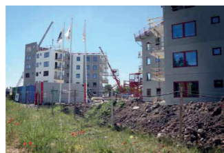
Adjutanten 1 Gotlandshem bygger 61 hyresrätter i två stjärnformade hus. Första spadtaget togs i december 2016. Första inflyttning i februari 2018.
