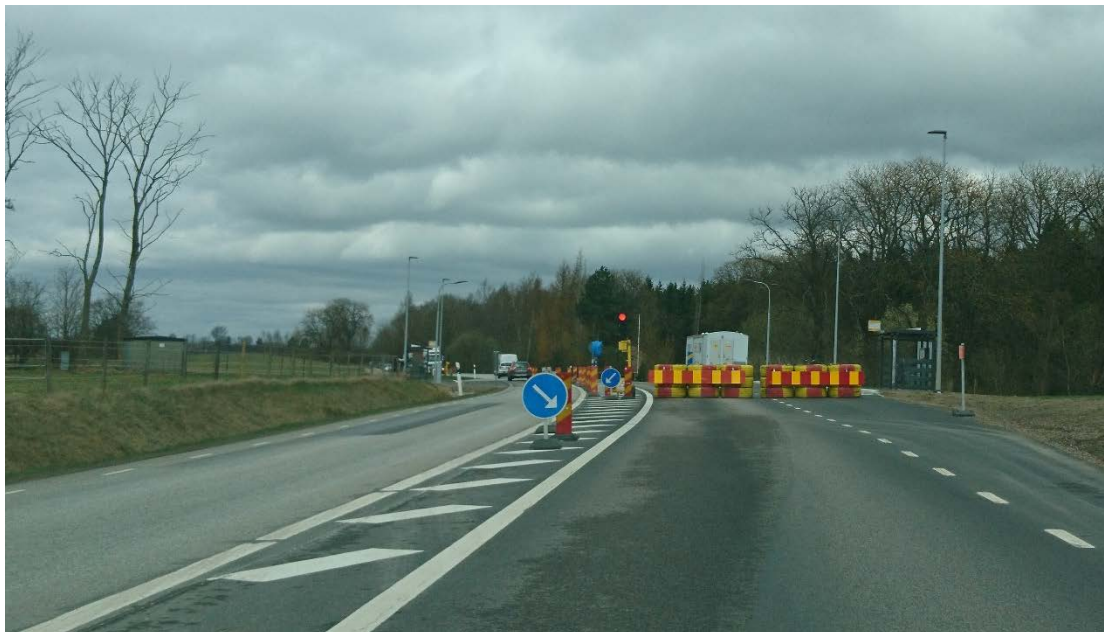
Figur 8. Trafikö vid omläggning av trafik i norrgående riktning på väg 108 vid Bökeberg.
