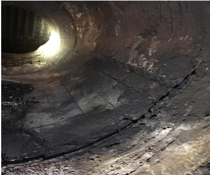
Figur 5. Brännarens utseende med en tydlig bild av de längsgående spalterna.
