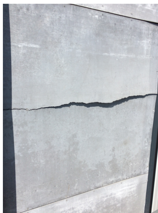
(b) Sprickbildning tvärs över en monterad vindskyddsskiva.
