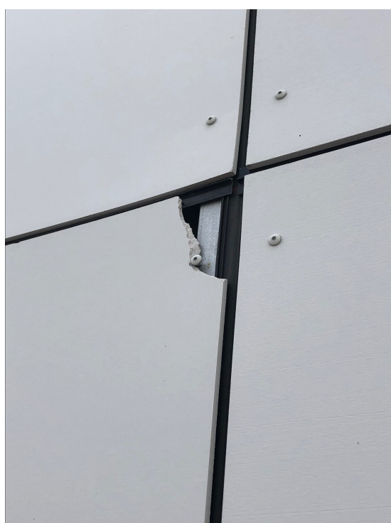
(a) Sprickbildning i hörnet av en monterad fasadskiva där en bit av skivan lossnat.
