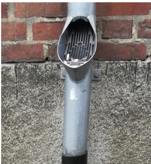
Figur B Tidy littering i en stuprörränna vid hållplats 5 - Esplanaden.
