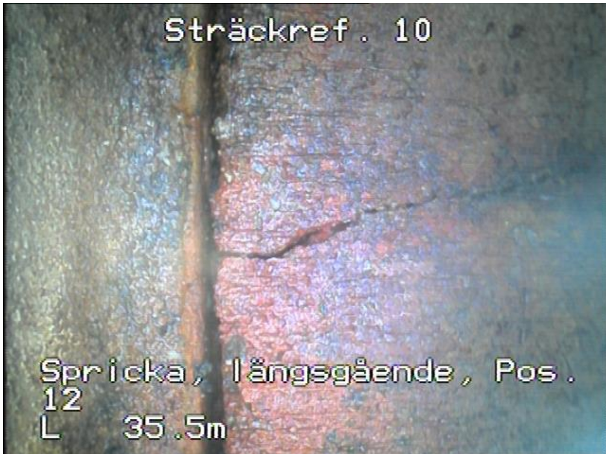
Appendix figur 17. Spricka i betongledning där det har läckt in vatten.
