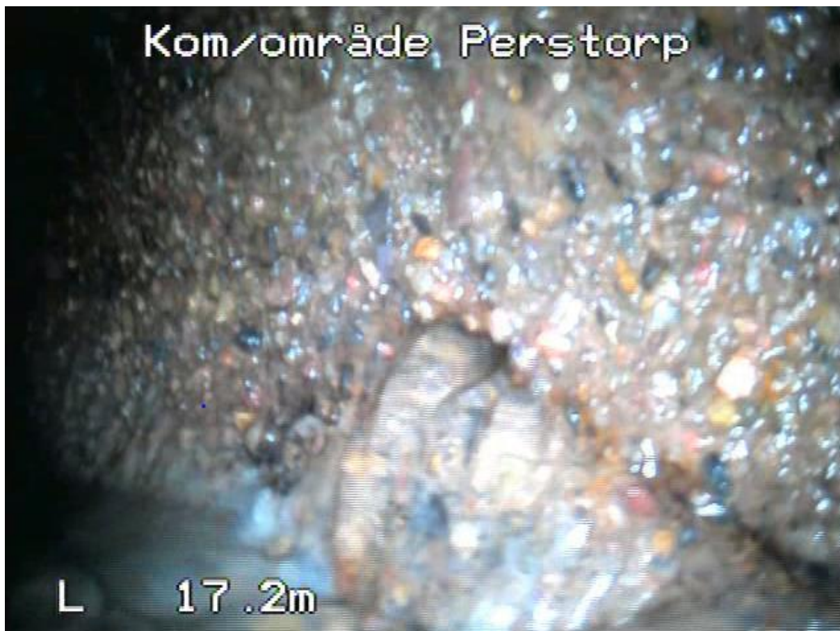
Appendix figur 16. Spricka i betongledning där strömmar in vatten.
