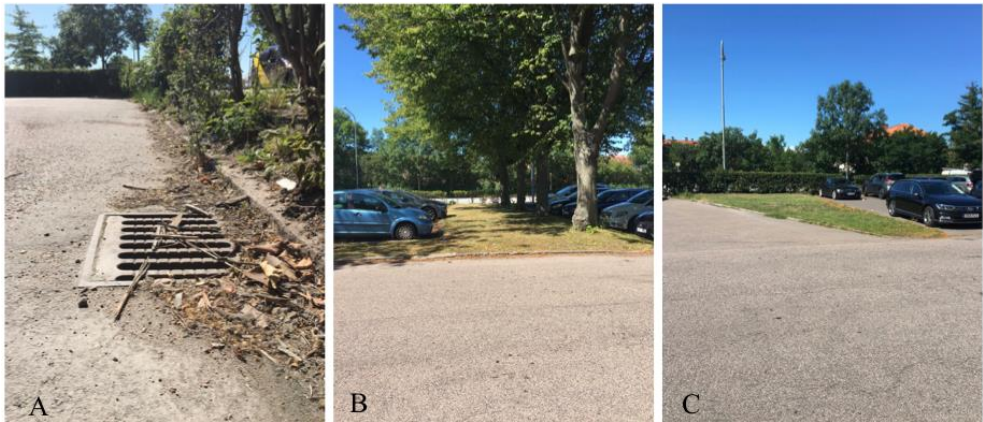
Figur 37. A, B och C. A: Dagvattenbrunn som leder dagvatten från parkeringen ner i ledningsnätet. B och C: Upphöjda gräsmattor mellan parkeringsrader. Foto: Lovisa Eriksson, 2019
