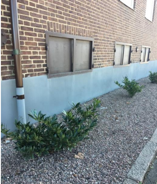
Figur 34. Byggnad med stuprör som leder regnvatten ner i ledningsnätet. Foto: Lovisa Eriksson, 2019
