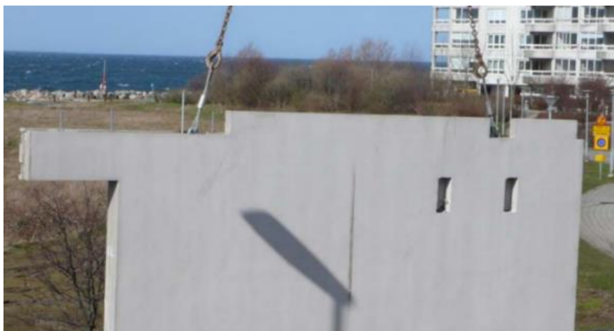
Figur 8 Lyft av väggelement med lyftögglor, i vänstra delen av elementet kan uppstick ses (ByggAi, 2008a).
