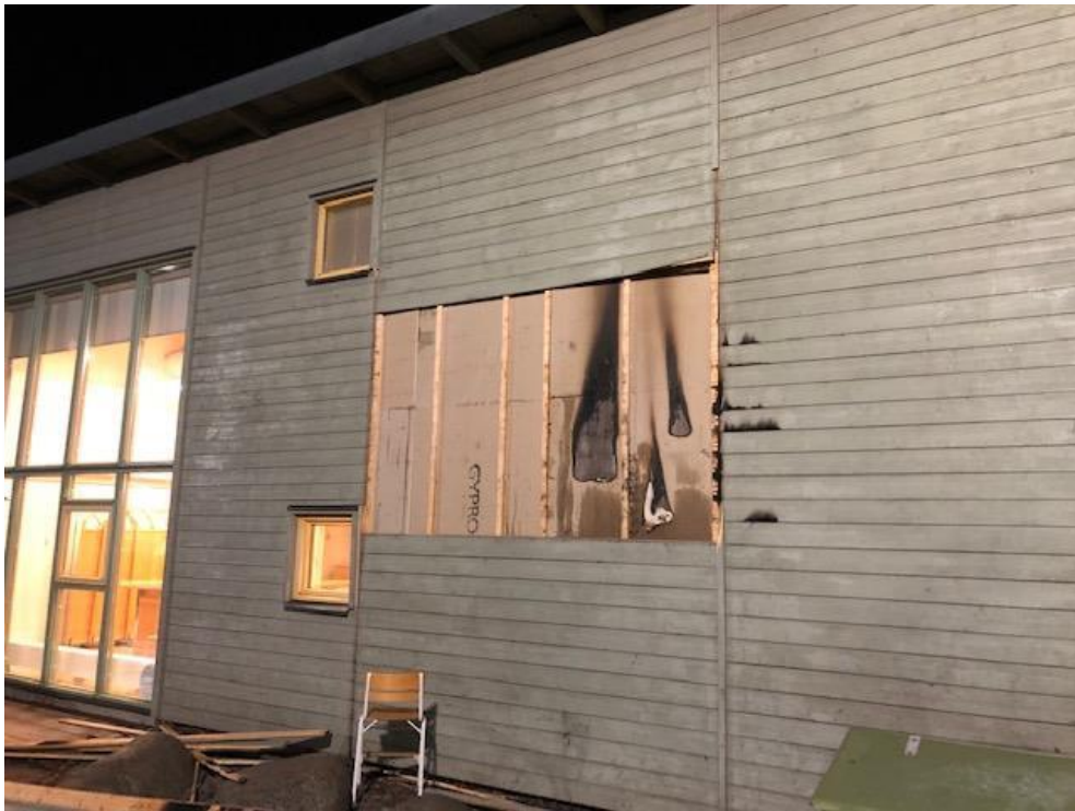
Fotografi 7: Bildexempel från en brand skolfasad, där branden släckts i ett tidigt skede. Väggen har frilagts i samband med släckinsatsen. Bildkälla anges ej.
