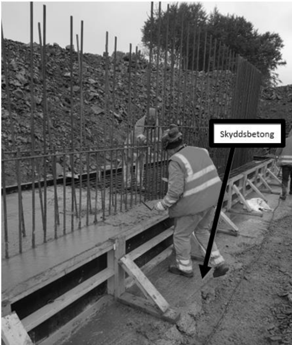
Figur 20. Visar gjutning av bottenplatta. Även hur skyddsbetongen används som avjämning samt till att fästa och sträva gjutformen i.
