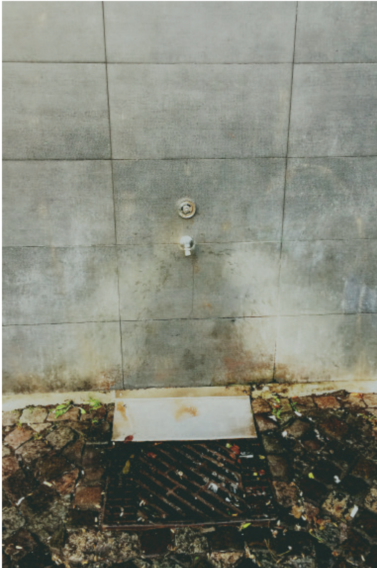
Vattenkran på Sibyllabygnades östra fasad
