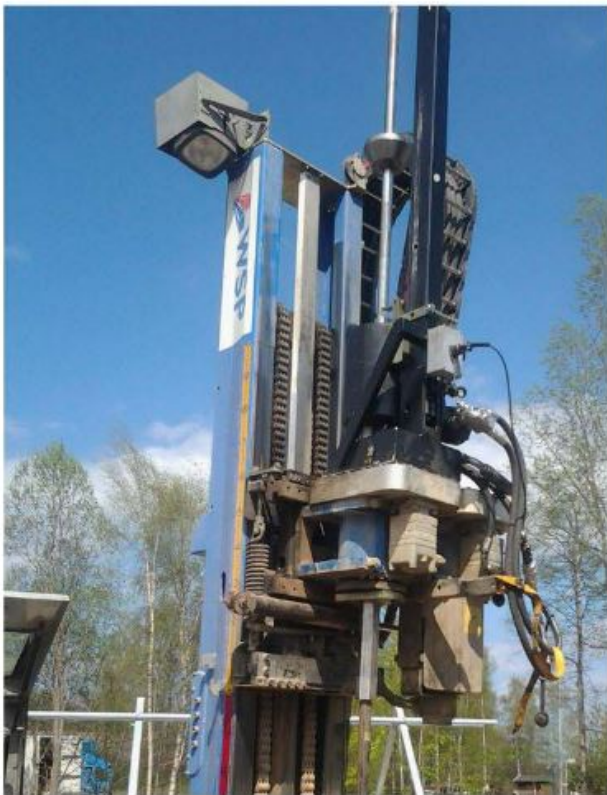
Hejarsondsutrustning monterad på en borbandsvagn.
