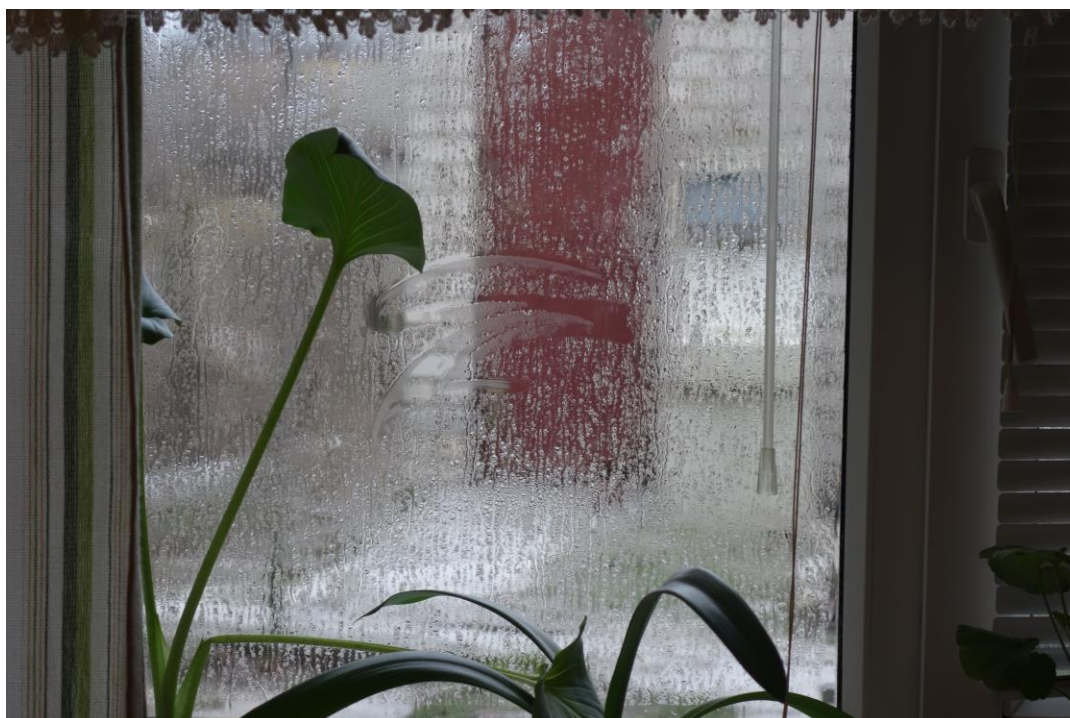
Figur 3.15: Kondens på insidan av fönsterrutan i sovrum på morgonen.
