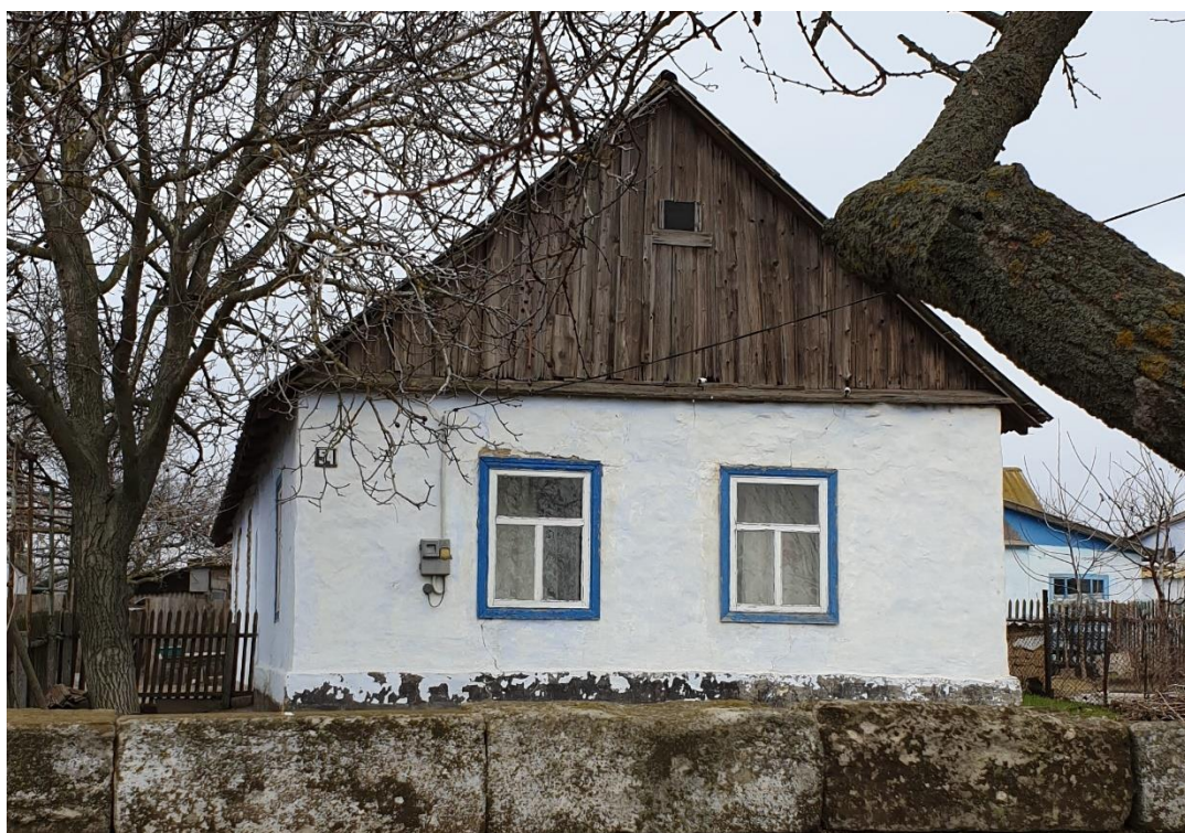
Figur 3.59: Byggnad S54, med antagande att stommen består av kримsten då fasaden ser ut att vara något ojämn. Fönsterna ser ut att vara av äldre typ. Sadeltak.
