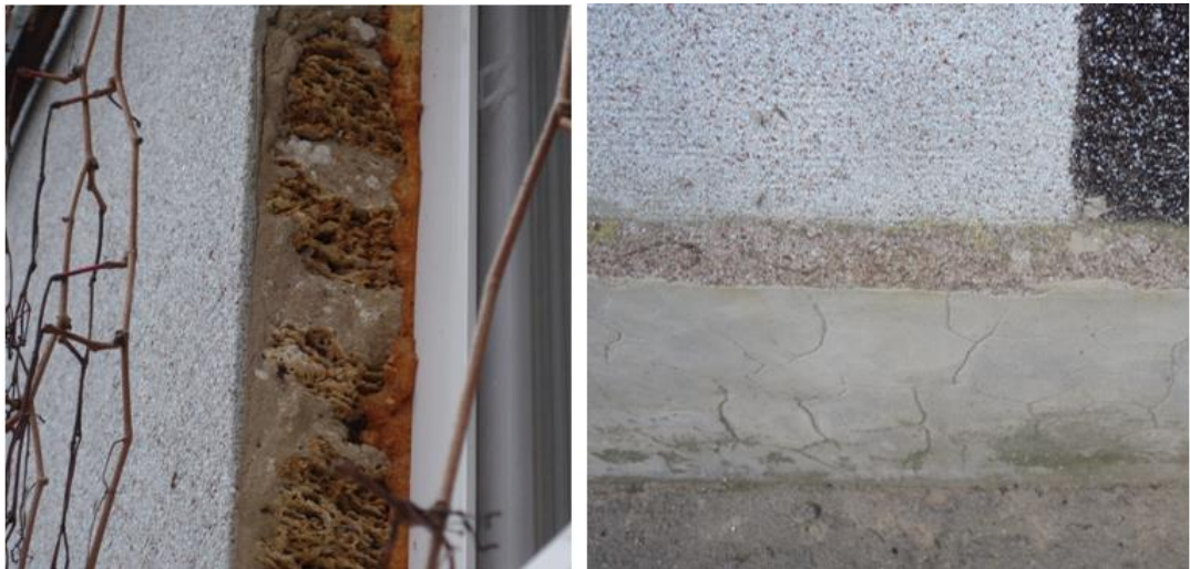
Figur 3.41: Uppbyggnad av väggen till vänster, och vägg som är redo för tilläggsisolering till höger.
