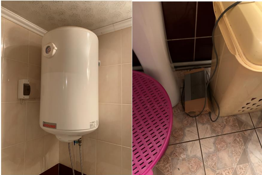
Figur 3.28: Varmvattenberedare och extern radiator i badrummet.
