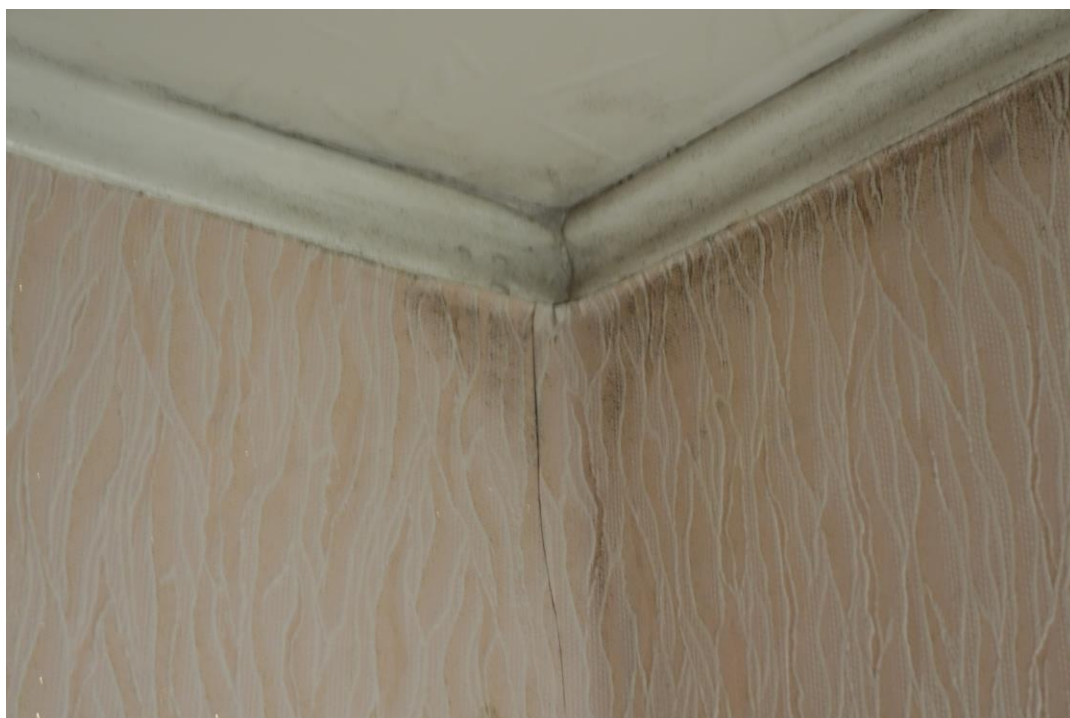
Figur 3.14: Anslutning mellan ytterväggar och tak i sovrum. Det något mörkare området är mögel.
