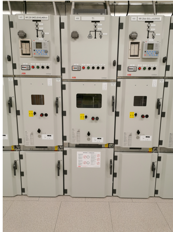
Figur 9: Luftisolerat mellanspänningsställverk på transformatorstation Stora Lund i Tranås.
