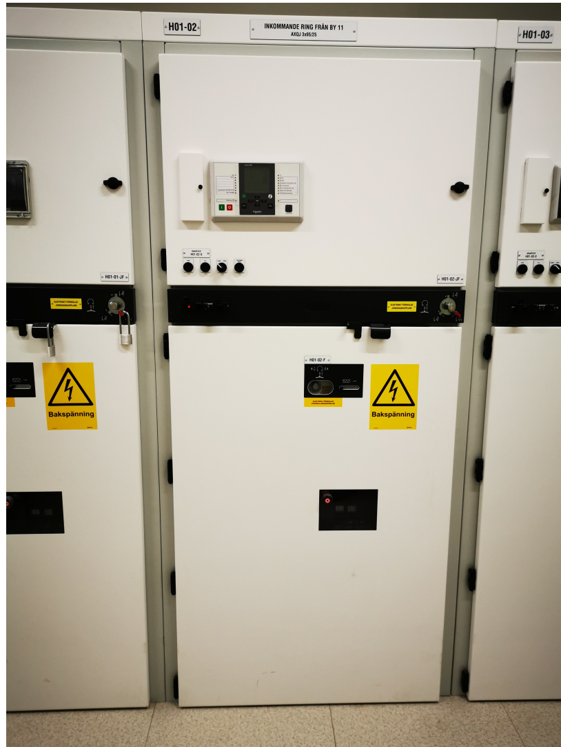
Figur 11: Luftisolerade ställverk i tågdepån i Hässleholm.
