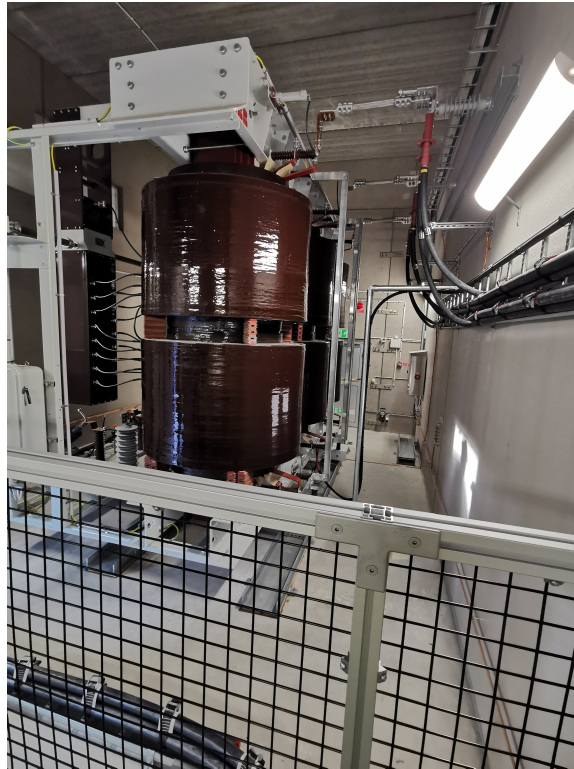
Figur 8: Torrisolerad transformator på transformatorstation Stora Lund i Tranås.
