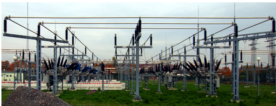
Figur 15: Trefasiga samlingsskenor i en transformatorstation, från (Wikipedia 2020).
