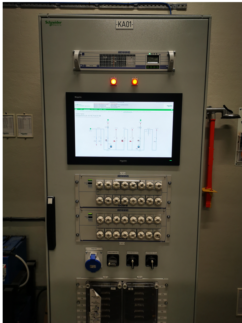
Figur 12: Elcentral för fjärrstyrning av ställverk.
