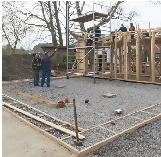
↑ I Musslor som takisolering, Munksøgaard II Muslingeskaller som byggemateriale, DR III offgrid Brenderup højskole
