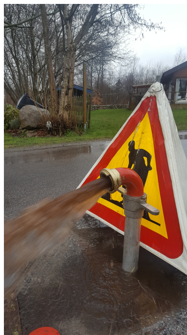
Figur 6: Vatten med kraftig missfärgning tas ut under luft- och vattenspolning, bild tagen under spolning på det ledningsnät som studerades
