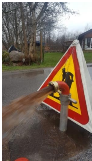
Figur 1: Luft- och vattenspolning av en ledning i det område som undersöktes. Kraftigt missfärgat vatten tas ut
