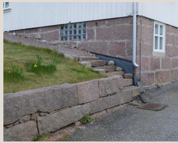
Där nivåskillnaderna är påtagliga, är i flera fall grunderna inskjutna i landskapet. I direkt anslutning till gatan, blir den höga grunden som en mur.
