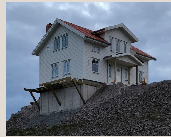
Ett av de senaste tillskotten hus i Bovallstrand, beläget på Korpåsbergets östra kant. En fundament gjutet i betong gör anspråk på bergskanten och möjliggör uppförandet av "kataloghus".
