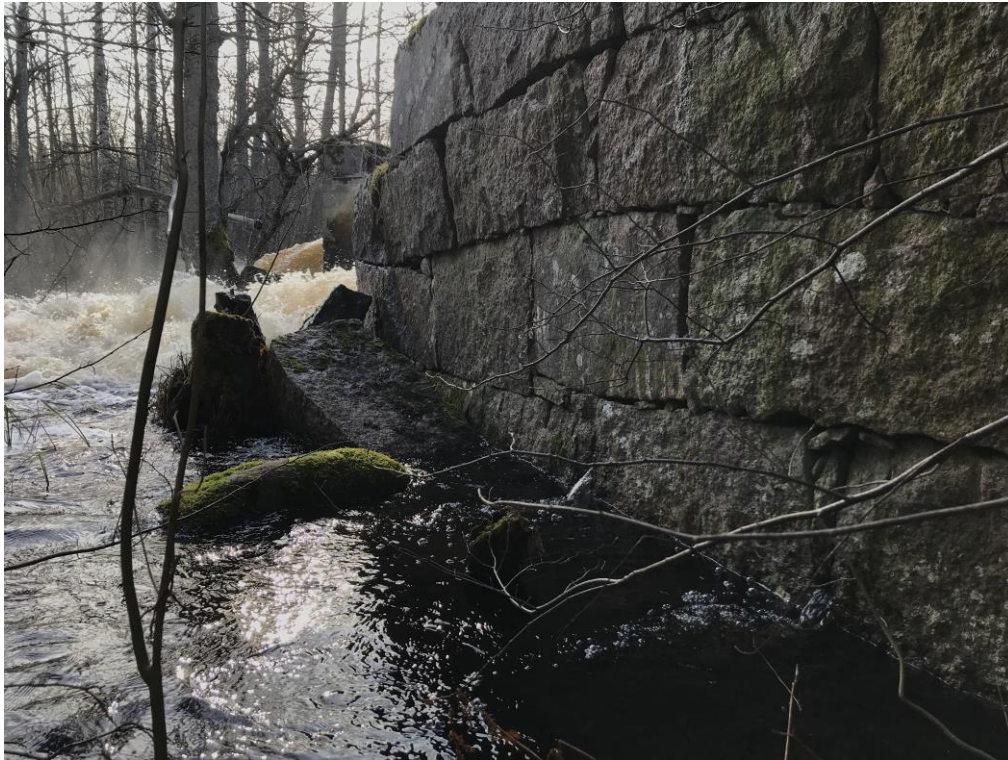
Bild 4. Detalj av en dåligt underhållen dammkonstruktion med läckage, sättningar och ras. Foto: Erik Jansson, 2020-02-24.
