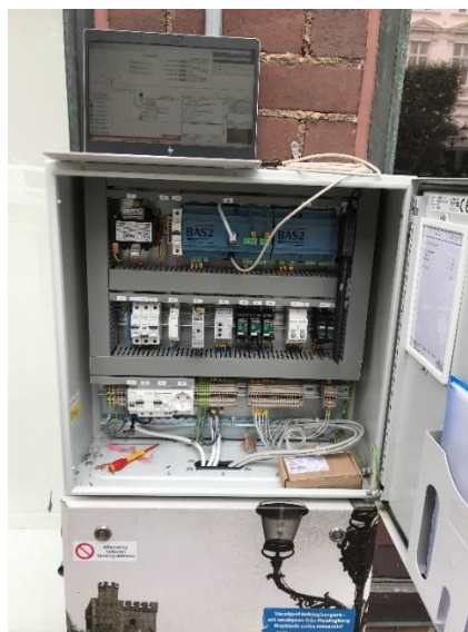
Figur 26: Elskåp med DUC installerad
